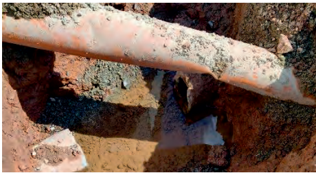
Stark wasserführende, beschädigte Drainageleitung im Bereich der Ebersbacher Straße
