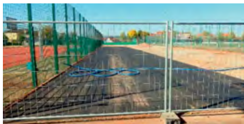
Der Standort für die Container-Schule ist bereits vorbereitet, die Versorgungsanschlüsse sind verlegt
