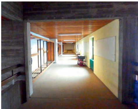
Flur im Schulgebäude. - Es gibt nur einen Ausgang. Im Obergeschoss führen fast alle Fluchtwege über ein zentrales Treppenhaus. Wenn das versperrt ist?
